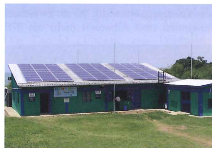
WE!Hub: Solar betriebene Energiestation. (Quelle: GNF)
