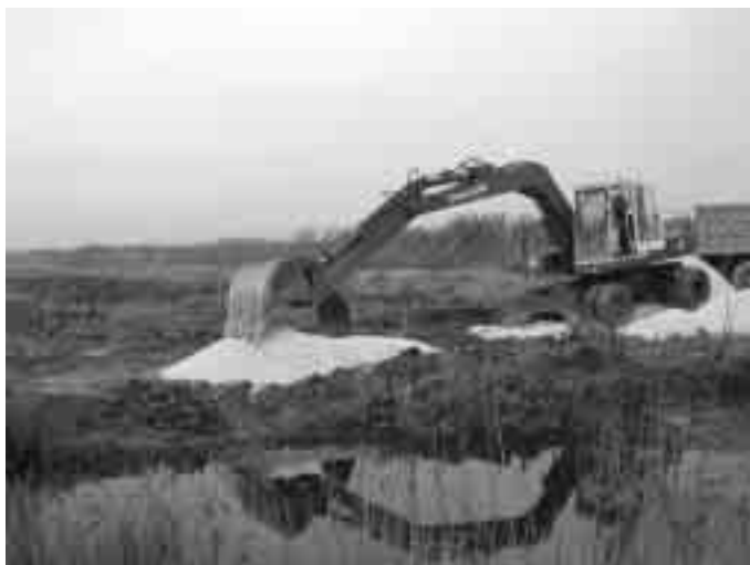
Κατασκευή φίλτρου χαλικιών και υπερχειλήσης μεταξύ των λεκανών της προστατευτικής ζώνης στη Βάσοβα
